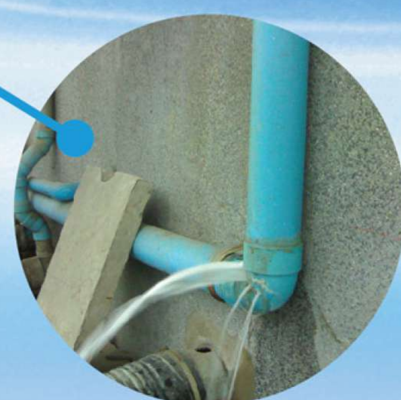
ท่อ PVC ไม่แข็งแรง กรอบแตก ร่วงง่ายกว่า
